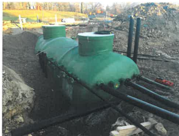
Bild erdverlegter Schwallwasserbehälter mit Pumpenraum für abgelegenes Kinderbecken
